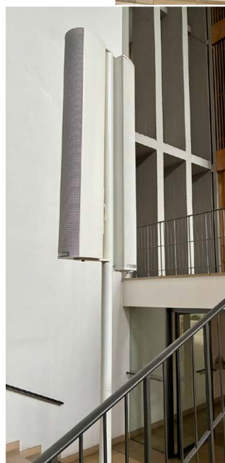
Die eleganten Lautsprecher der neuen Beschallungsanlage fügen sich optisch gut in die Kirche ein und sorgen mit einer speziellen Technologie für eine deutlich verbesserte Sprachverständlichkeit im gesamten Kirchenschiff.
